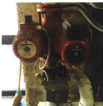
Dettaglio pompe M1 M2
