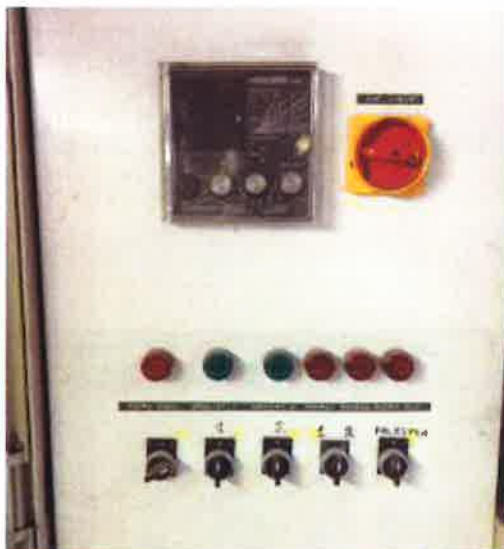
Dettaglio quadro elettrico
