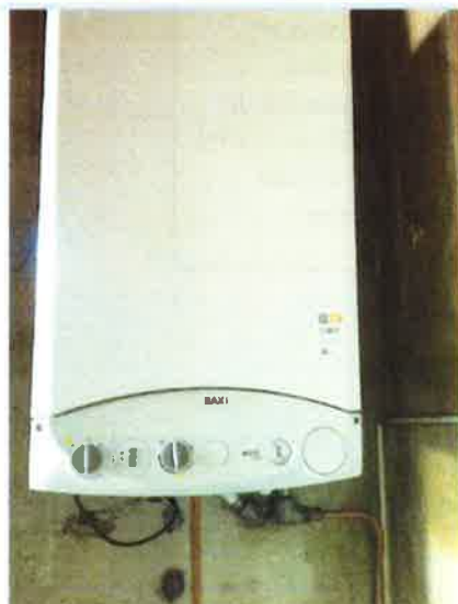
Generatore Sala Camino e Consiglio
