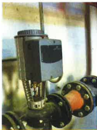
Valvola miscelatrice circuito Zona utilizzata da Comune
