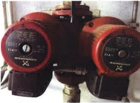
P2 – Pompa gemellare circuito Radiatori
