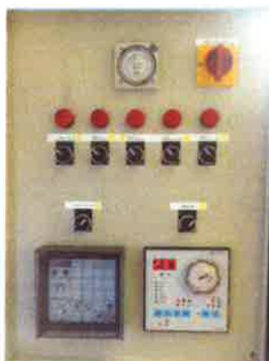
Dettaglio del Quadro elettrico
