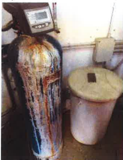
Sistema di addolcimento Acqua
