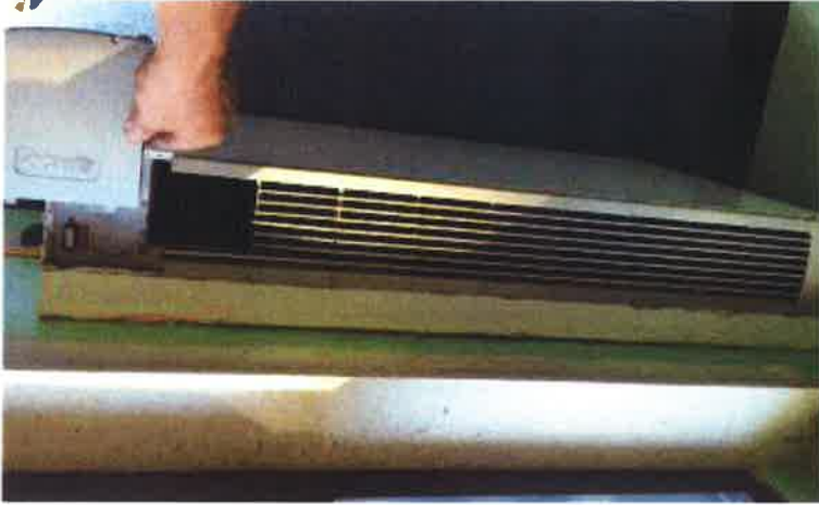
Dettaglio fan coil zona Mensa
