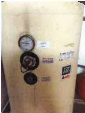
Boiler produzione sanitario
