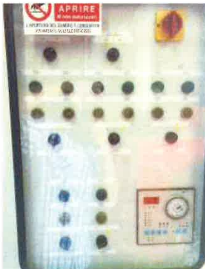
Dettaglio quadro elettrico di centrale termica
