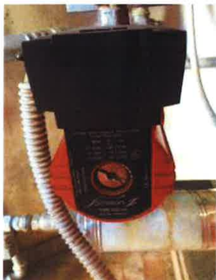
Circolatore P3 Carico Bollitore
