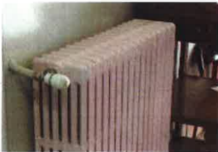
Dettaglio radiatori con valvole termostatiche
