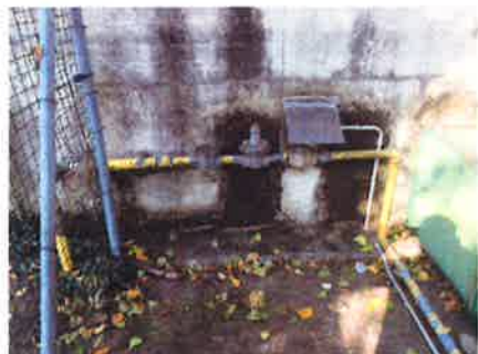
Dettaglio rete gas ammalorata
