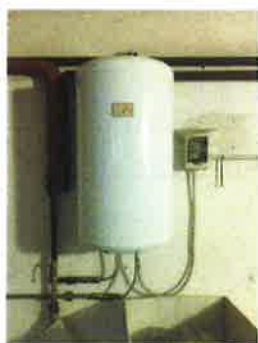
Boiler elettrico produzione ACS periodo Estivo
