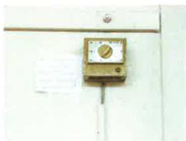
Dettaglio termostato palestra
