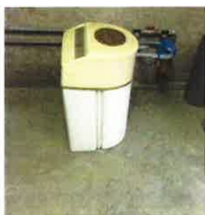
Dettaglio addolcitore non funzionante
