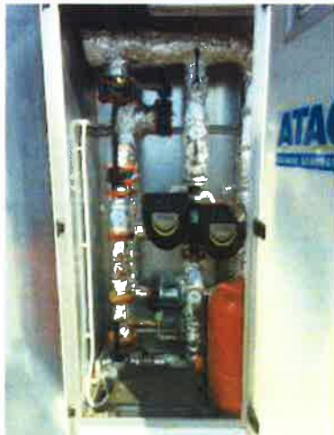
Dettaglio pompe a portata variabile circuito riscaldamento
