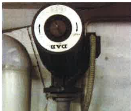
Dettaglio pompa anticondensa
