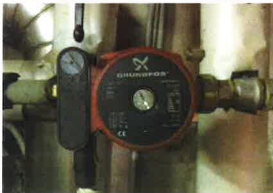
Dettaglio pompa anticondenza G1
