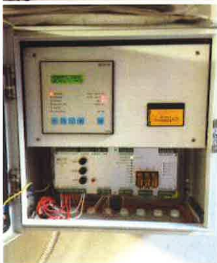
Dettaglio sistema di telecontrollo esistente non funzionante
