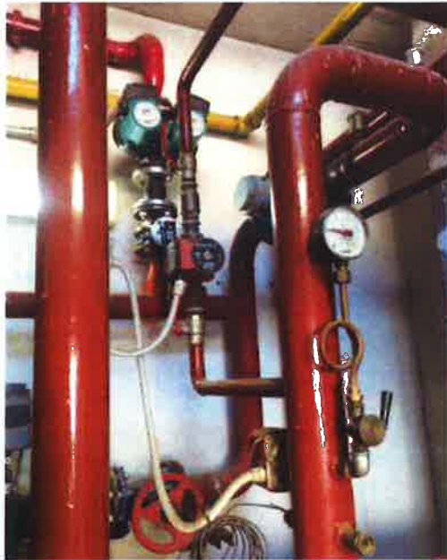
Dettaglio collettore riscaldamento
