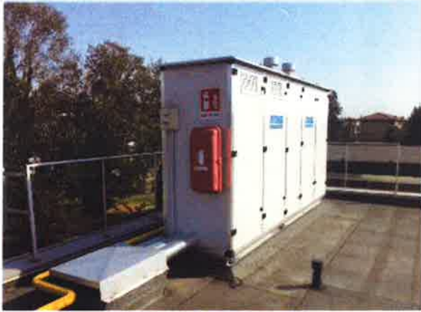
Vista dei nuovi generatori della nuova ala
