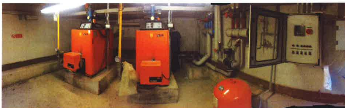
Vista panoramica della centrale termica
