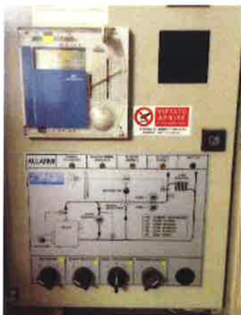
Dettaglio quadro elettrico
