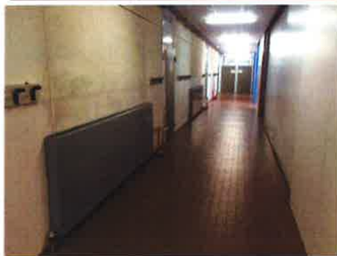
Dettaglio vecchia radiatori in ferro a pistre
