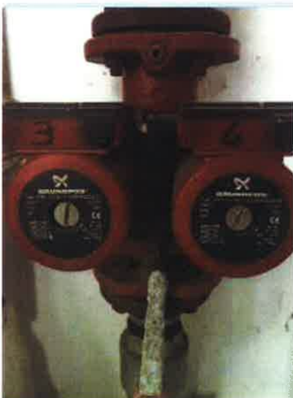
Circolatori riscaldamento biblioteca P2
