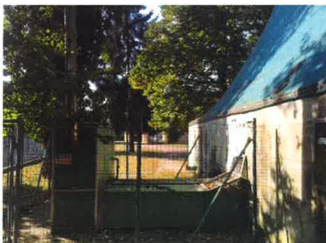
Dettaglio generatore di calore ad aria
