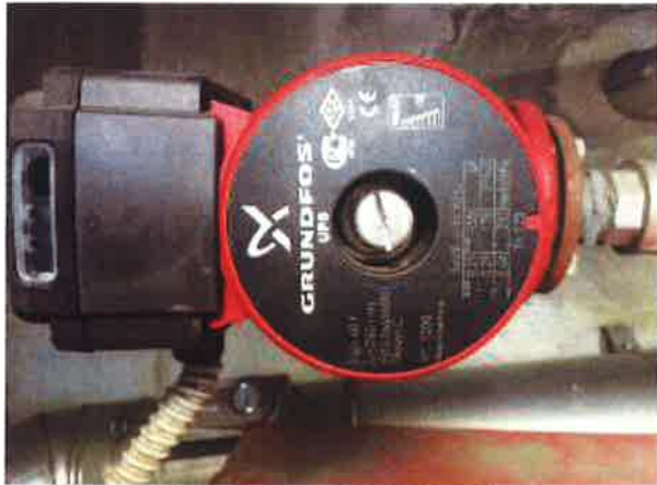
Dettaglio pompa anticondenza G2
