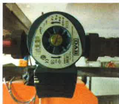
Dettaglio pompa anticondensa
