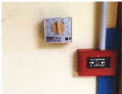
Dettaglio termostati ambiente
