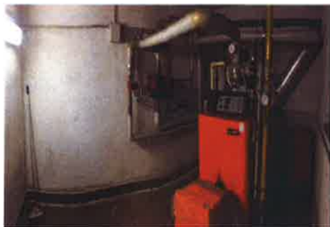
Vista del generatore di calore
