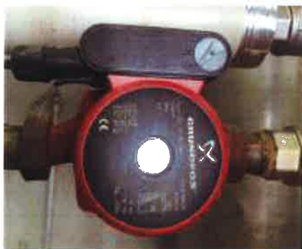
Circolatore P1 Primario Boiler
