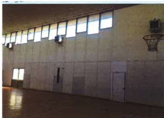
Dettaglio aerotermi asserviti alla palestra
