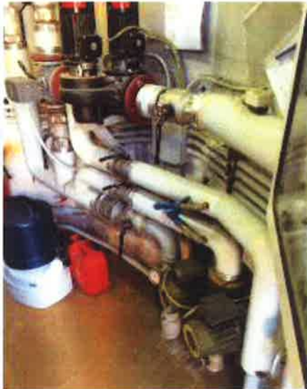
Dettaglio collettore riscaldamento
