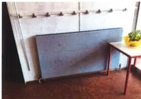
Dettaglio vecchia radiatori in ferro a pistre
