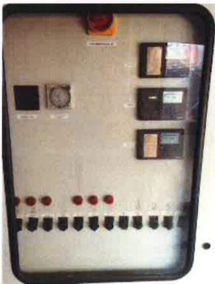
Dettaglio quadro elettrico
