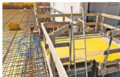
8 La scala supera di almeno 1 m il piano superiore; l'accesso è sicuro grazie alla presenza dei parapetti.
